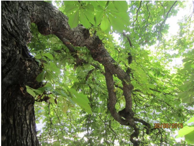
Abb. 61 Problematik alte ausladende untergeordnete Starkäste im Kronenzentrum
